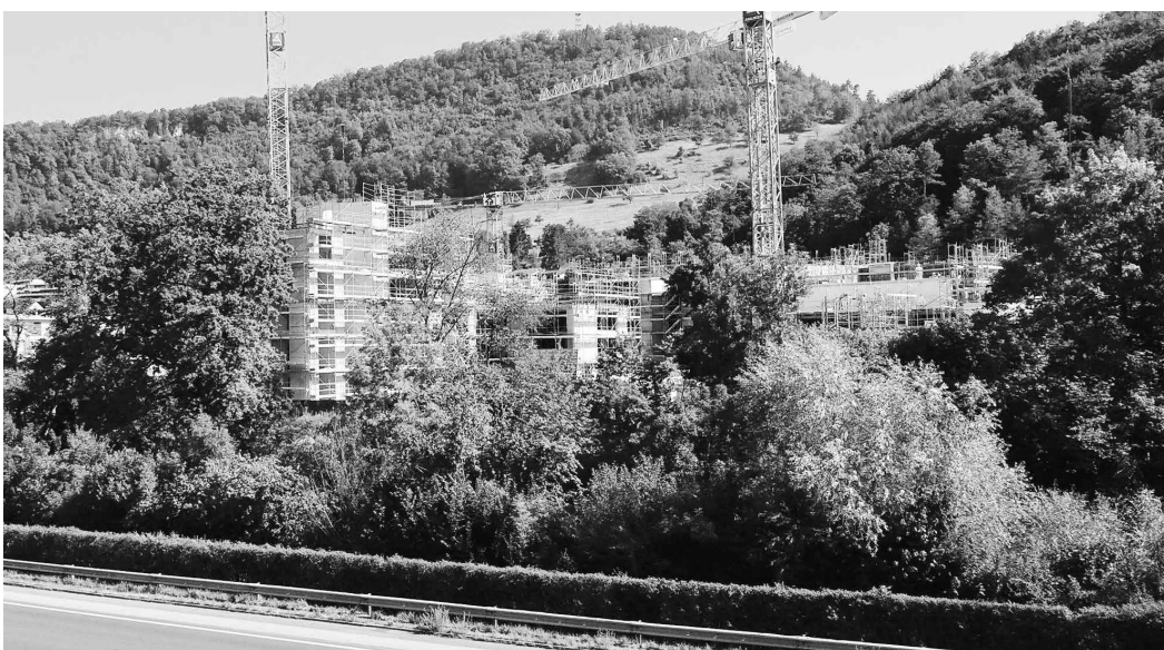
Blick über die A22 und Ergolz auf den Bau im Grammet Haus 1 (Bürgergemeinde) im Bild auf der linken Seite und in der Mitte, Haus 2 (Crédit Suisse) im rechten Bildteil. Vermietung ab Herbst 2019, Mietbeginn Spätherbst 2020, Eröffnung Doppelkindergarten August 2020. Daniel Sturzenegger
