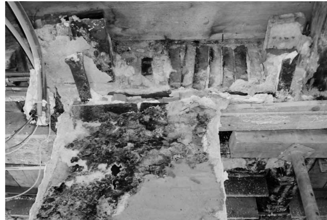
Bauzustand: Chaos pur
