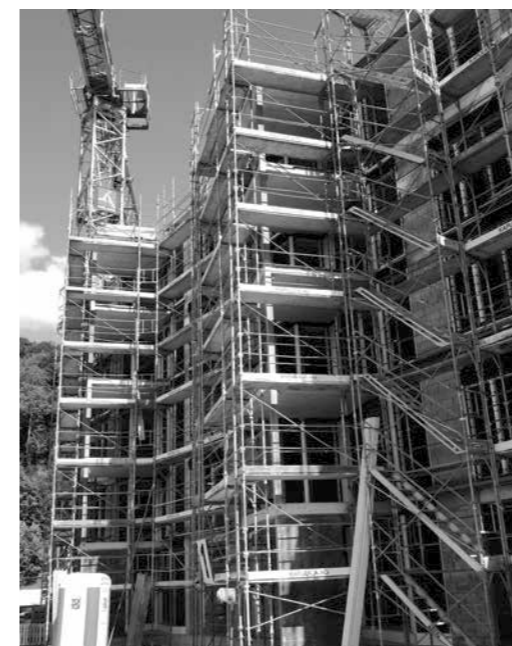
Blick auf den Bau im Grammet Haus 1 (Bürgergemeinde) / Westfassade: der Einbau der Fenster hat begonnen.
