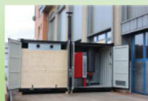
Container 1+2: Wärmeerzeuger + Brennstofflager
