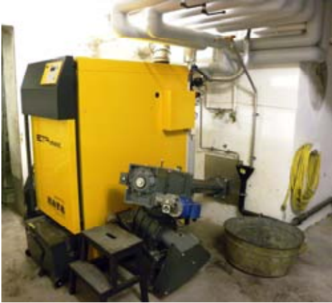
Neue Heizanlage (Pellets)
